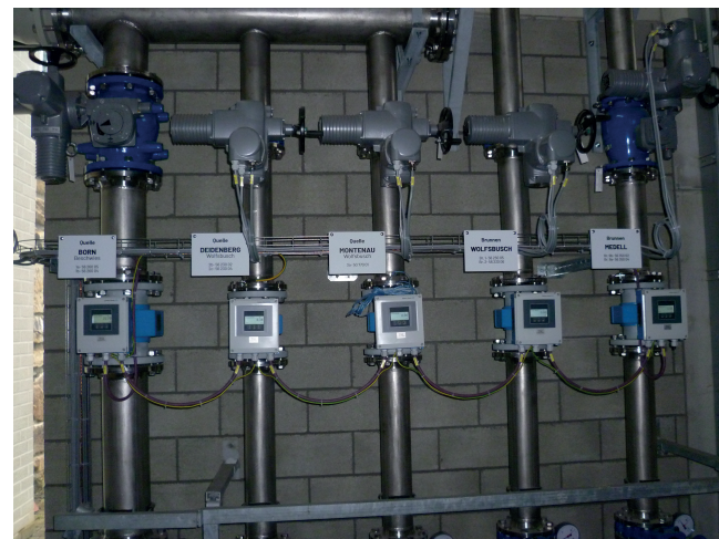
Das Wasserwerk Wolfsbusch
