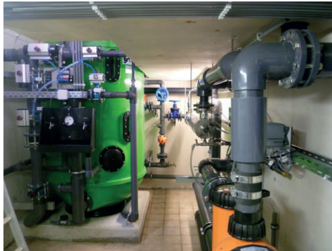
Innenansicht Wasserwerk Wereth
