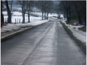
Der Verbindungsweg von Halenfeld nach Honsfeld muss grundlegend erneuert werden.
