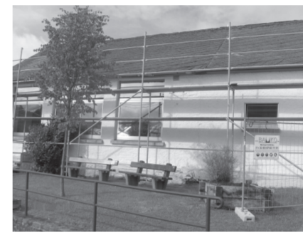
Im Herbst 2010 strahlt auch das Dorfhaus Meyerode in neuem Glanz. Hier hat das Unternehmen Elsen/Heppenbach das günstigste Angebot unterbreitet. Die Arbeiten in Höhe von 125.000 € umfassen vor allem die Erneuerung und Isolation des Daches und der Fenster.
